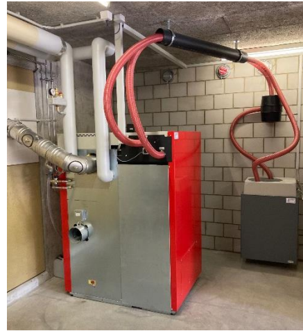
Neue Pelletheizung Gemeindehaus
